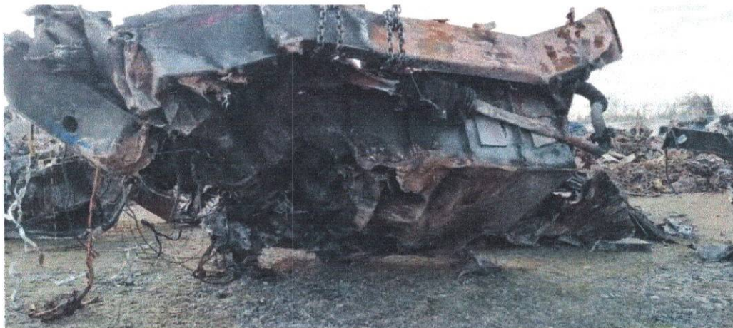
Φώτο 35. Μετασχηματιστής ηλεκτράμαξας 120-023, (επιβατική IC62)
